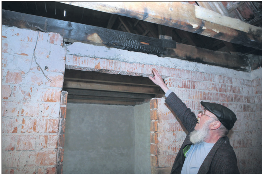
Albert Munz zeigt, wie extrem verkohlt die Holzstrukturen über dem Brandherd sind. Sie werden demnächst erneuert.
