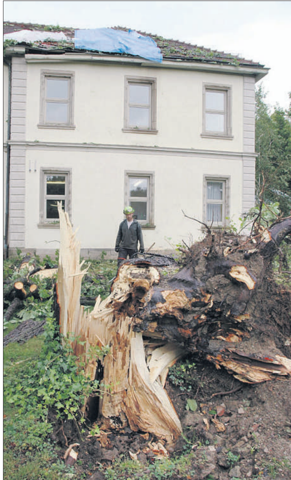
Ein umgerissener Baum im Schlosspark hat das Dach des Schlosses beschädigt.
