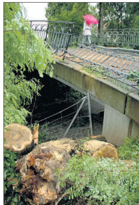
Fußgängerbrücke bei der Schlosskirche: Geländer durch einen umgestürzten Baum beschädigt
