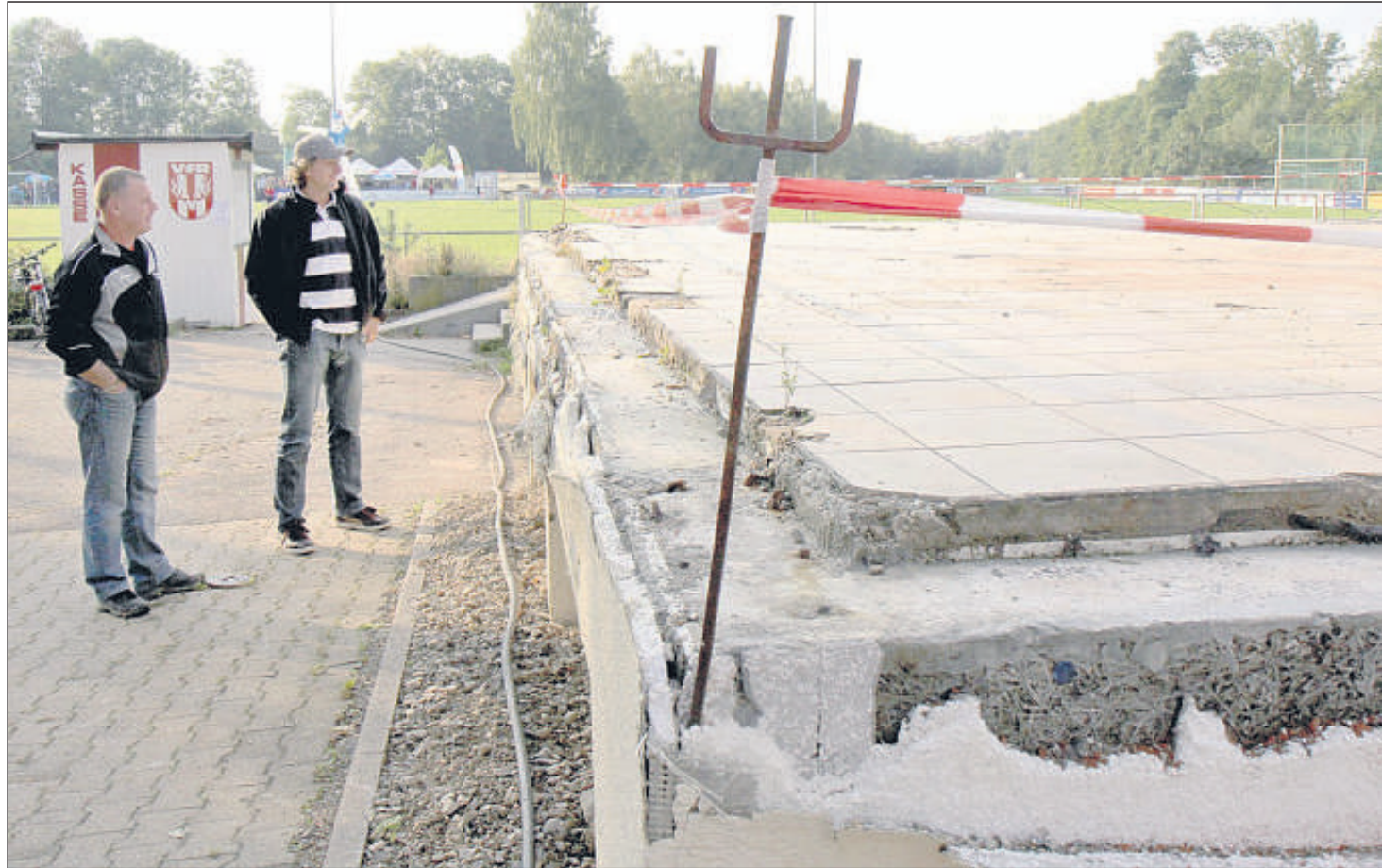
Die Brandruine des VfR-Vereinsheims jetzt: Dem Verein ist durch die Brandstiftung ein großer Schaden entstanden, den die Versicherung nur zum Teil abdeckt. Auch dies kam in der Urteilsbegründung zur Sprache. Bild: Büttner
